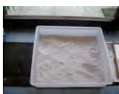
Photo 1 : « Bac à sable » positionné sur la chaufferie
